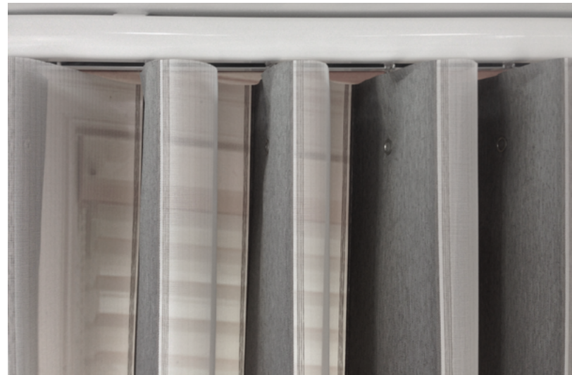
Forma incorrecta de Instalar las lamas
